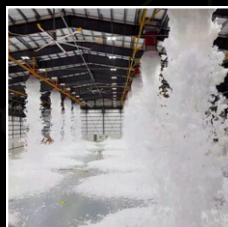
Extinción por espuma
