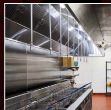
Protección para cocinas
