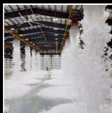
Extinción por espuma
